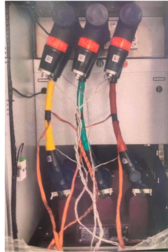
Ячейки КРУ-Т с трансформатором напряжения и ОПН
